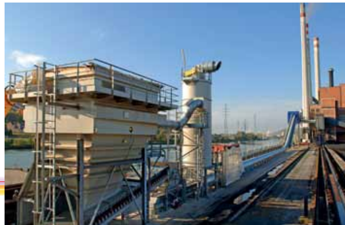
Trémie de réception des granulés de bois et bande transporteuse
