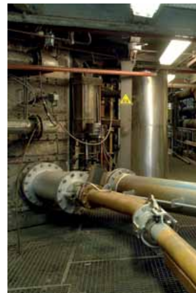
Conduite (jaune) de bois pulvérisé et brûleur
