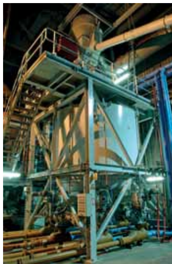
Tour de broyage : broyeur, trémie et pneumatiques (tuyaux jaunes)
