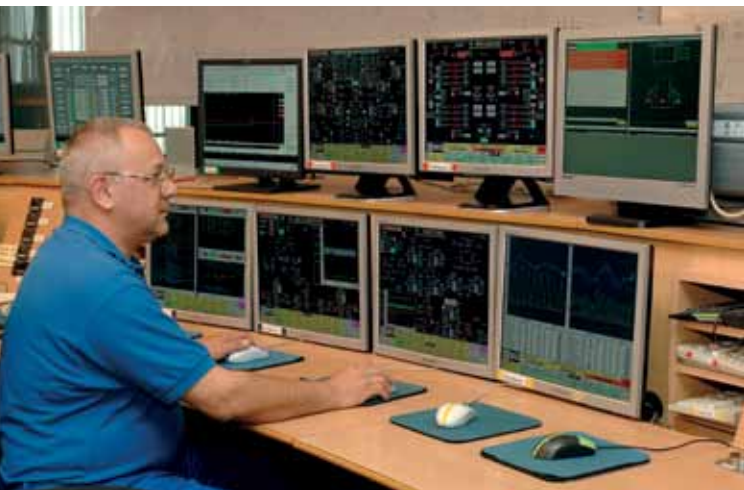
Salle de contrôle
